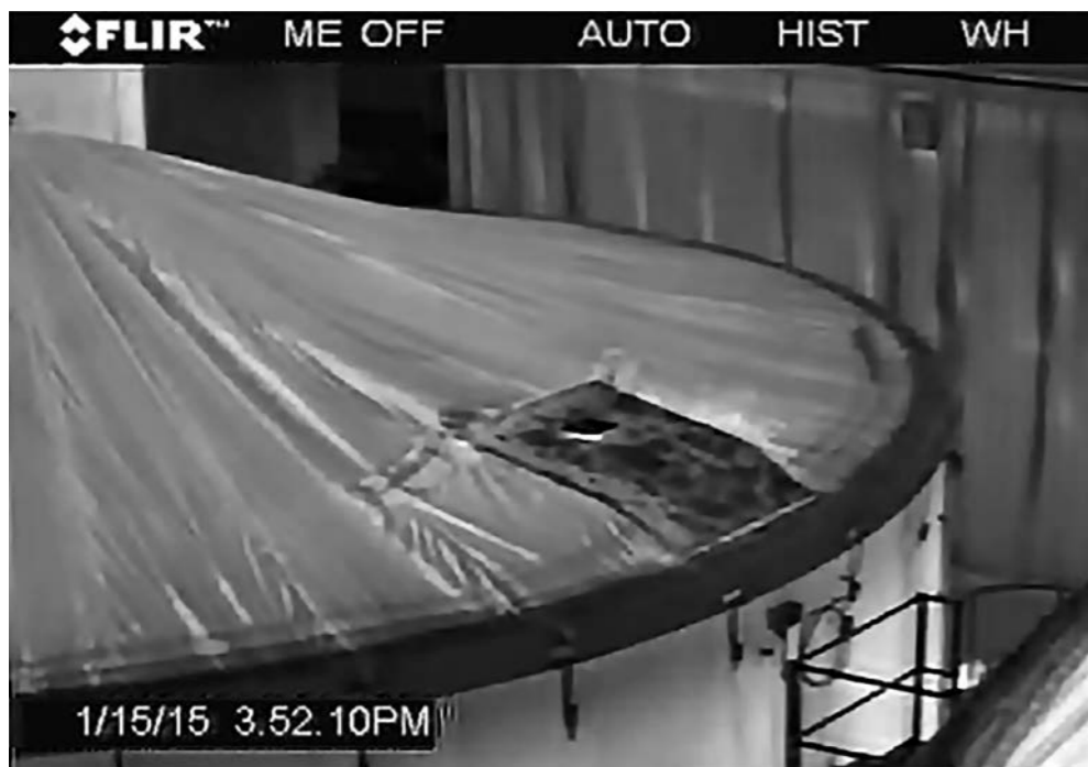
Gaslekken worden gedetecteerd met behulp van infraroodtechnologie.
