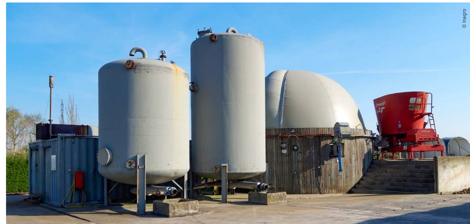
Biogasinstallatie op Inagro.
